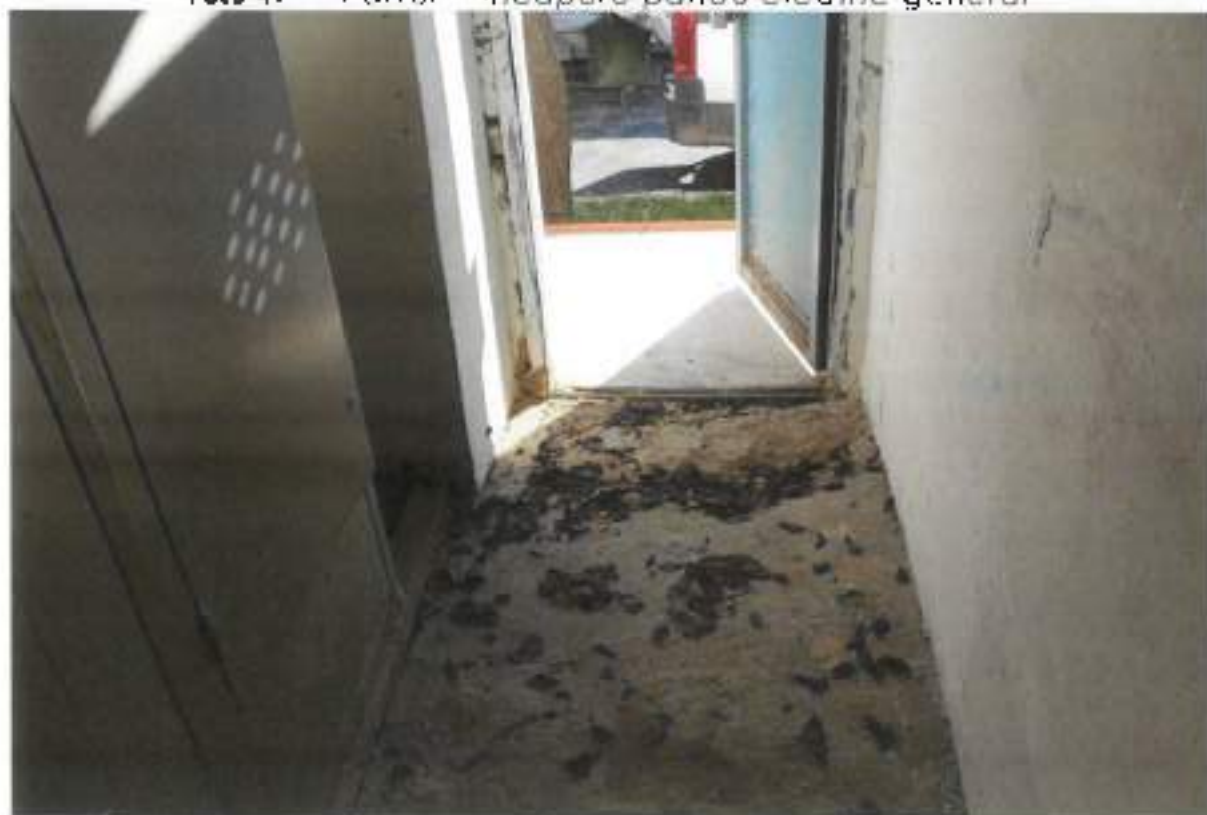
Foto 48 - Parter - Incapere panou electric general
