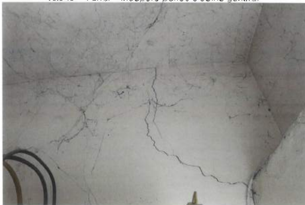
Foto 46 - Partea inferioară a unei pereți dintr-o încăpere a panoului electric general
