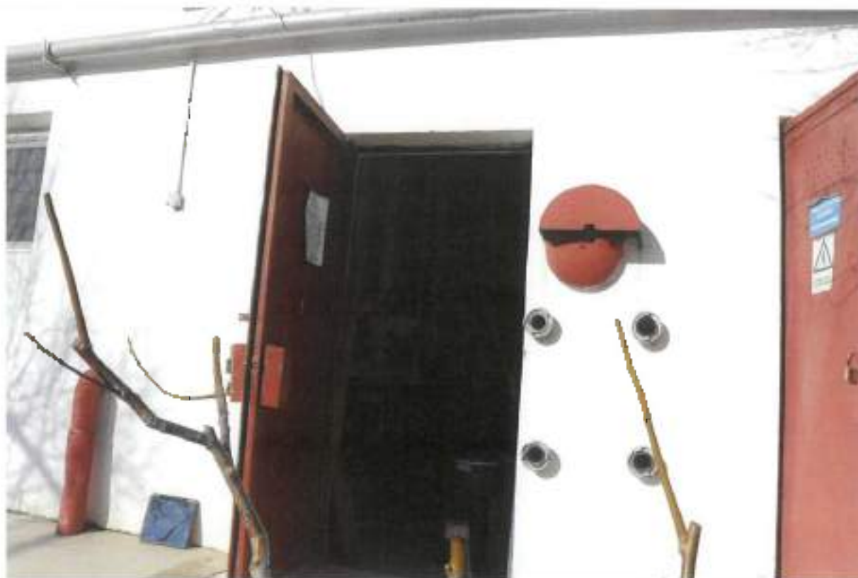
Foto 43 - Parter - incapere panou electric generai
