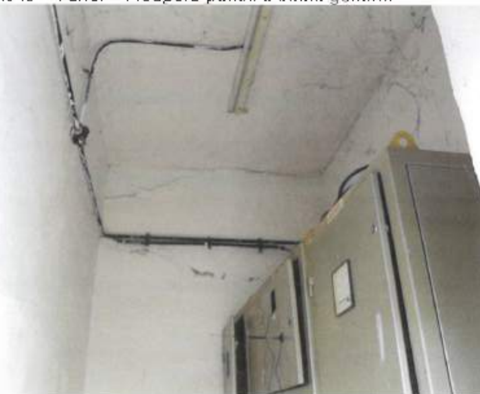
Foto 44 - Parter - Incapere panou electric generai
